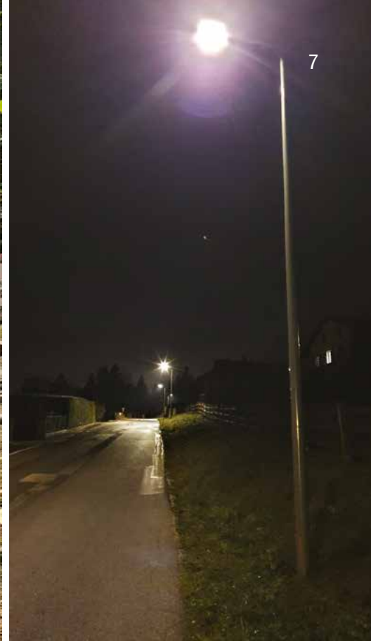
Rue équipée de luminaires LED
